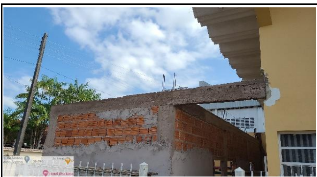
FOTO 3 - vista externa novo ambiente de três salas. Alvenaria e concretagem dos elementos estruturais concluído
