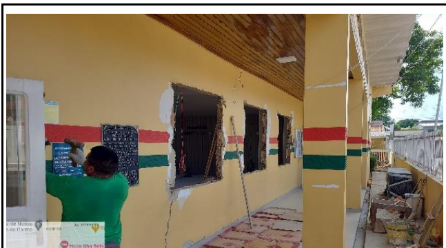
FOTO 21 - retirada das esquadrias antigas para dar lugar as novas esquadrias que serão instaladas
