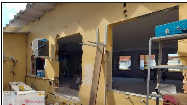
FOTO 11 - vão fechado, conforme projeto
