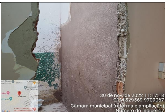
FOTO 11 - vão fechado, conforme projeto
