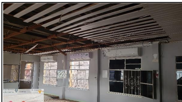
FOTO 22 - necessária retirada de equipamentos (ar condicionado e roteador)
