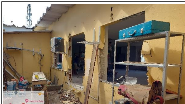
FOTO 10 - demolição de esquadrias antigas para adequação e conformidade com o novo projeto
