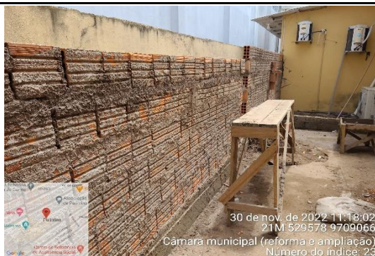
FOTO 15 - alvenaria lateral concluída onde teremos ampliação com acréscimo de duas salas (transmissão e assessoria)
